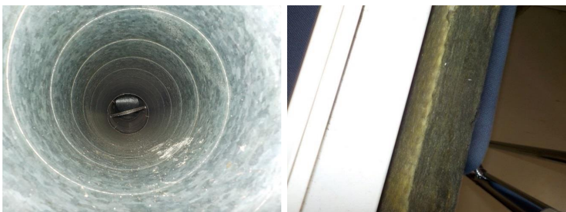
Kuvat 31. ja 32. Tuloilmakanavissa ja kanavien päätte-elimissä jonkin verran pölykertymää ja likaa
