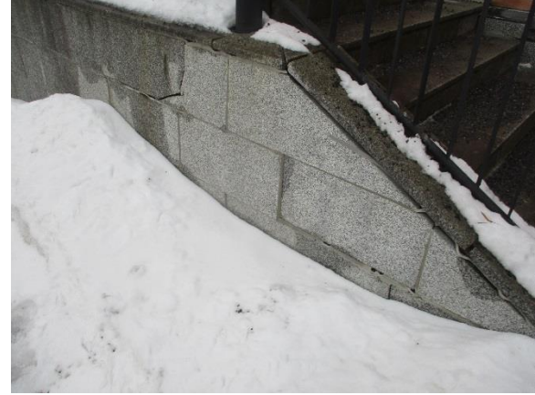
Kuva 38. Portaissa halkeamia ja vaurioita
