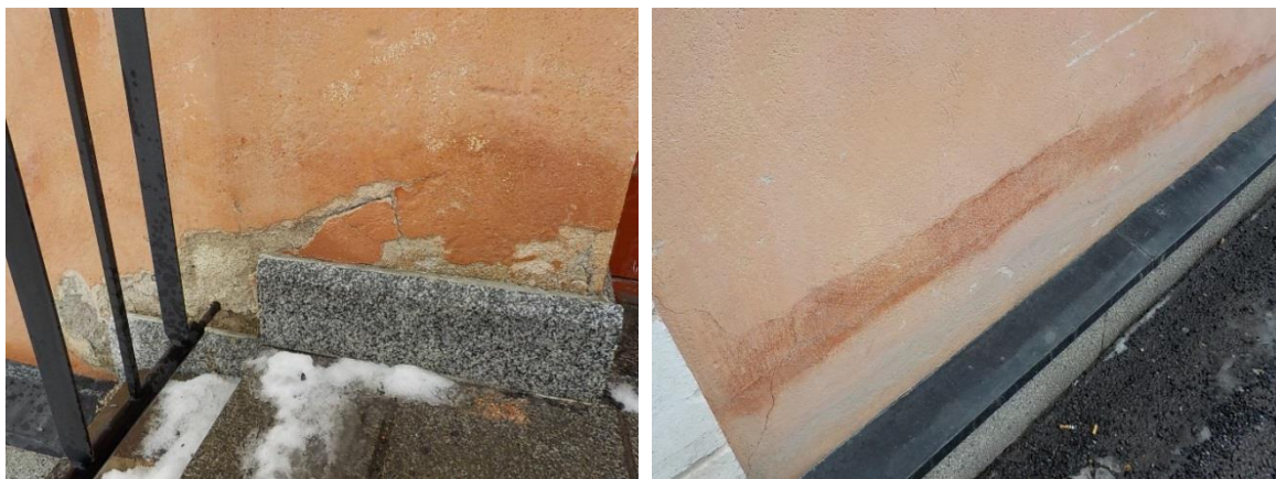
Kuvat 24. ja 25. Halkeamia, rapaumaa ja tummentumia rakennuksen julkisivussa
