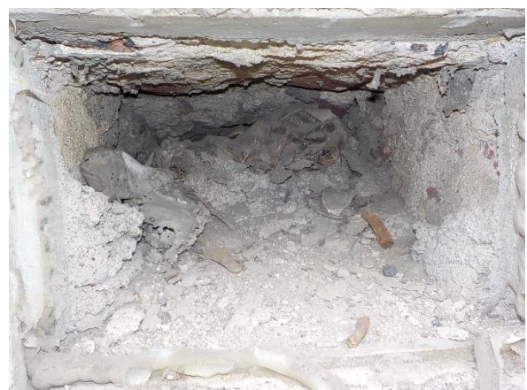
Kuva 6. Tuuletusluukut osittain tukkeessa
