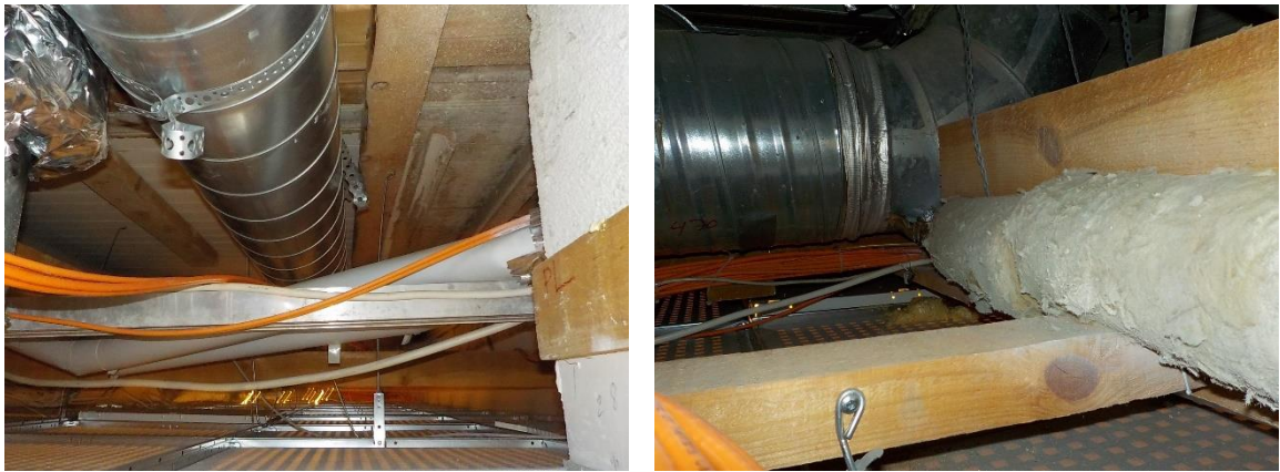
Kuvat 22. ja 23. Alakattorakenteiden päällä kulkee talotekniikkaa, joiden mineraalivillaeristeet avoimina. Alakattolevyjen päällä mm. hiekkaa.
