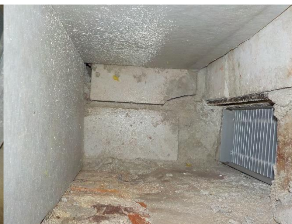
Kuva 34. Siirtoilmakanavassa mineraalivillalevyjä ja likaa
