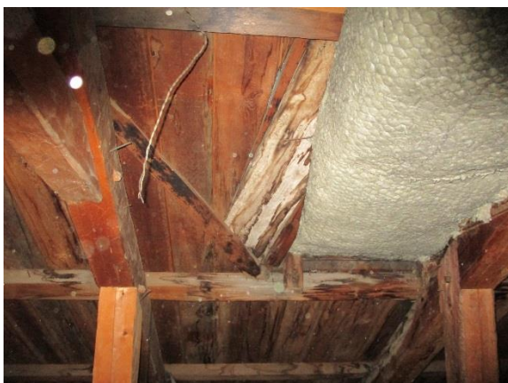
Kuva 20. Kosteusjälkiä läpiviennin ympärillä
