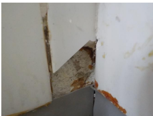
Kuva 39. ASB.01 Seinälaatan saumausaine
