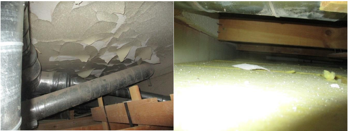
Yläpohjan alapinnan rappauksessa vaurioita, rappausta ja avoimia mineraalivillapintoja 2. kerroksen alakattojen päällä
