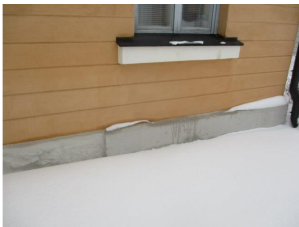
Sokkelirakenteessa paikoittain tummentumia ja valumajälkiä
