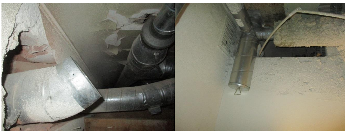
Avoin IV-hormin pää alakattorakenteen yläpuolella, rakenteissa vanhoja IV-hormeja ja avoimia läpivientejä sekä avoimia mineraalivilloja.
