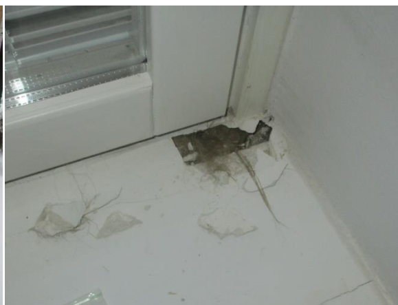
Ikkunarakenteiden rakenneavaus (tilkkeissä mikrobivaurioita)
