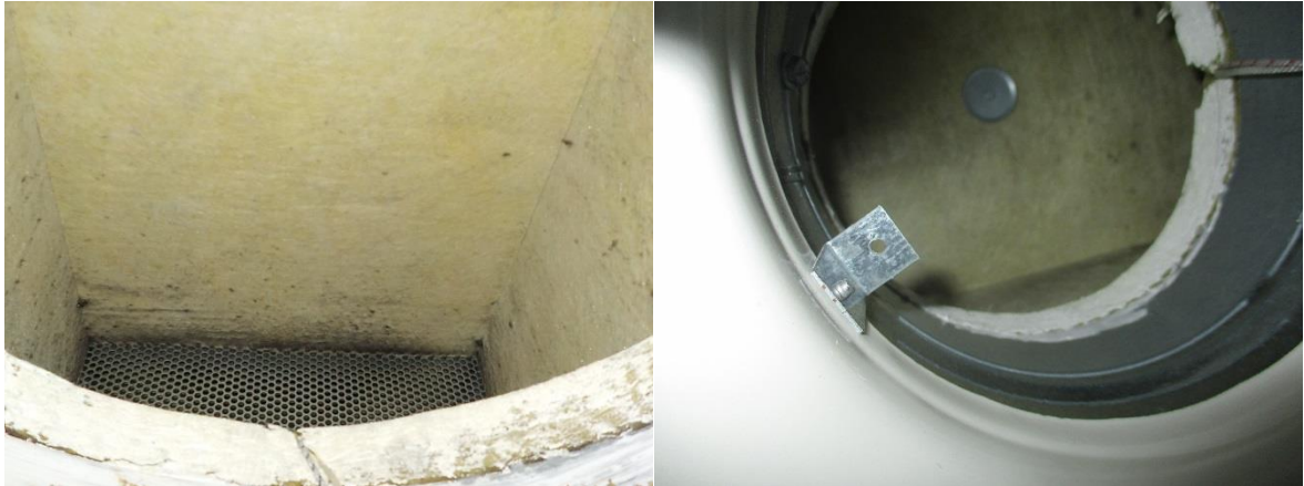
Tuloilmakanavissa ja kanavien pääte-elimissä avoimia mineraalivillapintoja ja likaa
