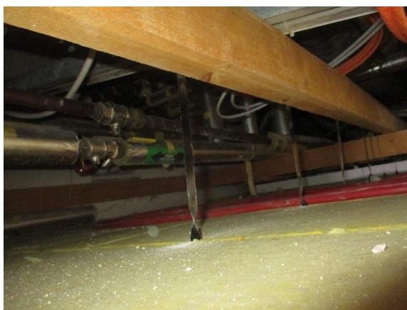
Yleiskuva 1. kerroksen alakaton yläpuolelta, rappausta pudonnut levyjen päälle
