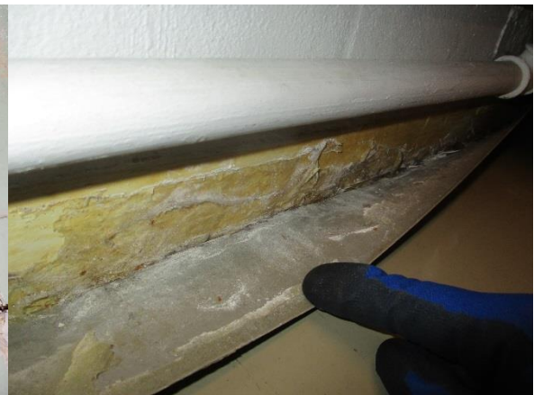
Listojen takana merkkejä kosteusrasituksesta
