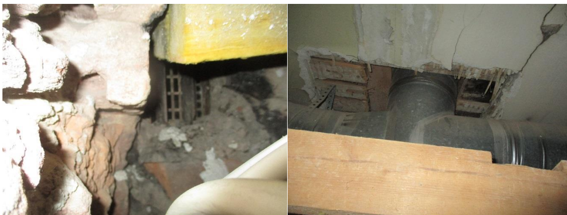
Rakenteissa avoimia IV-läpivientejä ja vanhoja hormoneja, joissa muun muassa rakennusjätettä ja mineraalivilloja.
