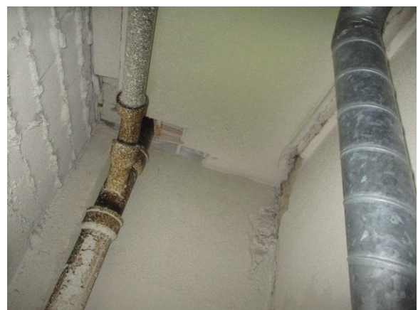
Välipohjarakenteen alapinnassa, nykyisen alakaton yläpuolella, vaurioita rappauksessa
