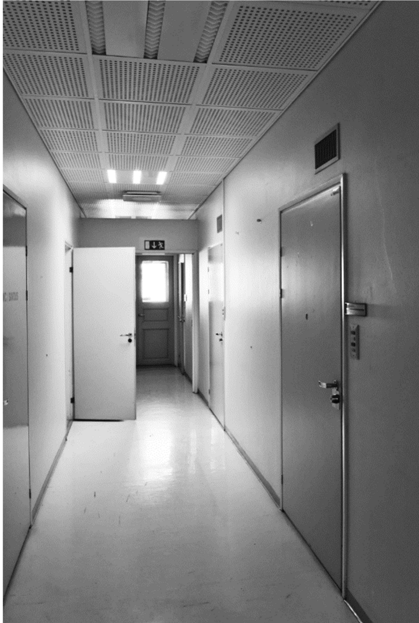
Kuva: Keskikäytävästä otettu kuva rajattu vanhan sairaosaston tilaan, jossa siis keskikäytävän leveys ja väliovien paikat entisellään. Käytävää reunustavat huoneet ovat yhtä väliseinin jaettua lukuun ottamatta entisessä koossaan. Käytävässä on alakatto.
