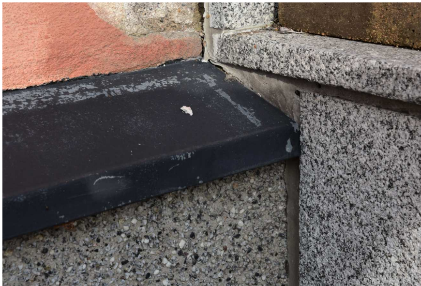
Kuva: Rakennuksen luonnonkivestä ja tiilestä tehty kivijalka on ilmeisen varhain pinnoitettu rappauksella. Nykyinen rouhepintainen rappaus on tehty vuosituhannen vaihteessa. Betoniportaat on päällystetty kivilaatoilla.
