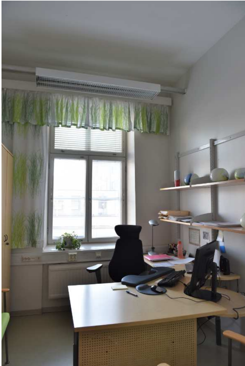
Kuva: Kaikki ikkunat uusittiin 1970-luvun puolivälissä T-karmillisina. Vain ulkopuolteisiin on tehty vanhojen ikkunoiden ruutujakoa jäljittelevät pysty- ja vaakapienat.
