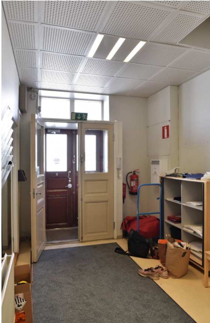
Kuva: Entiseen leipomon ja pesulan eteiseen on tehty pieni tuulikaappi. Ulko-ovet ja tuulikaapin ovet teetettiin päärakennuksessa säilyneiden vanhojen peiliovien mallilla 1970-luvun puolivälissä. Ullakon puuportaat on purettu ja korvattu kattoluukulla.
