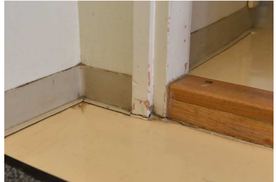
Kuva: Huoneissa on 1970-luvun PVC-matot, puukynnykset ja muoviset/kumiset lattialistat. Puset ovielistat ovat suorat ja kapeat.
