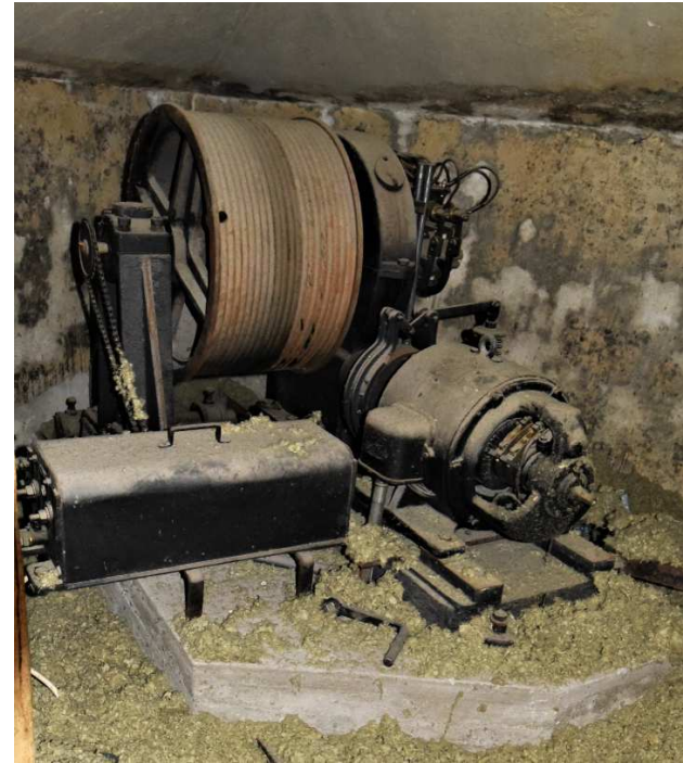
Kuva: 1920-luvun hissikone on edelleen paikallaan ullakolla 20-luvulla rakennetussa lisäosassa.
