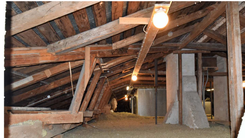
Kuva: Ullakkotilaa vuonna 2019. Etualalla on rapattuja tiilihormoja. Etualan katonosassa on uudempaa aluslaudoitusta, harvempaa ja erisuuntaista kuin vanha.
